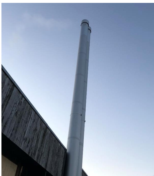
Kaminanlage in Betrieb
