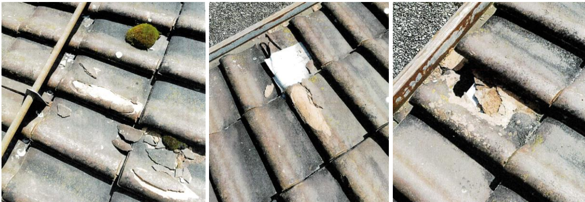
defekte Ziegel Mehrzwecktrakt Schulhaus Walkringen
